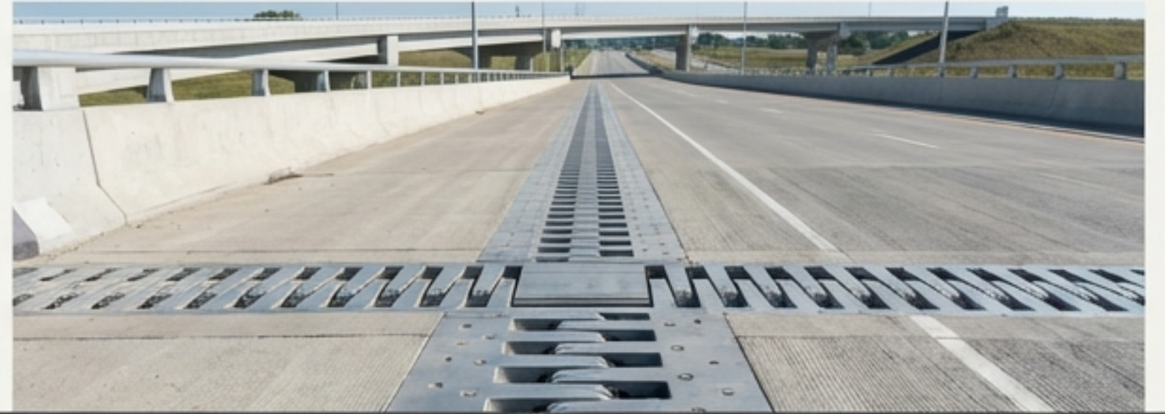
Pontes e Viadutos: Juntas de dilatação absorvem a expansão estrutural.
