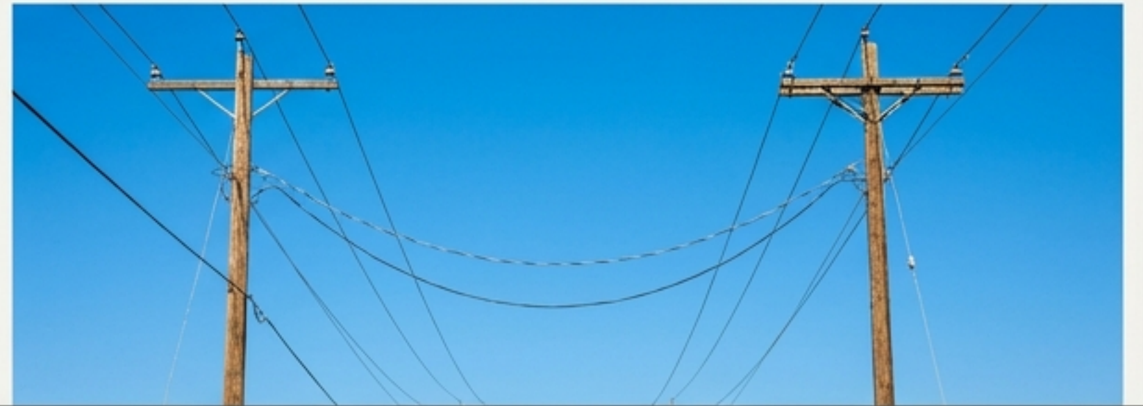
Fios Elétricos: Ficam esticados no frio e frouxos no calor extremo.
